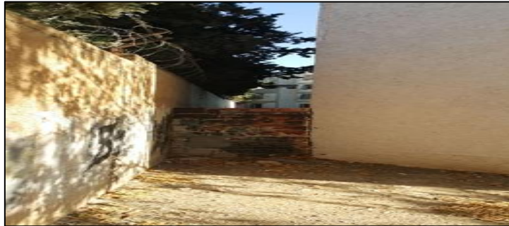
Figure V.7 : Un mur de cloisonnement entre le bloc et le mur de clôture de la faculté de pharmacie. Source : Auteur, 2021.
